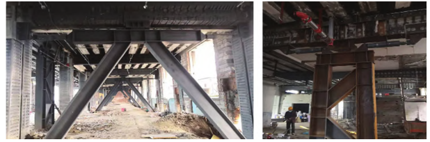
图 13 黏滞阻尼器现场照片
